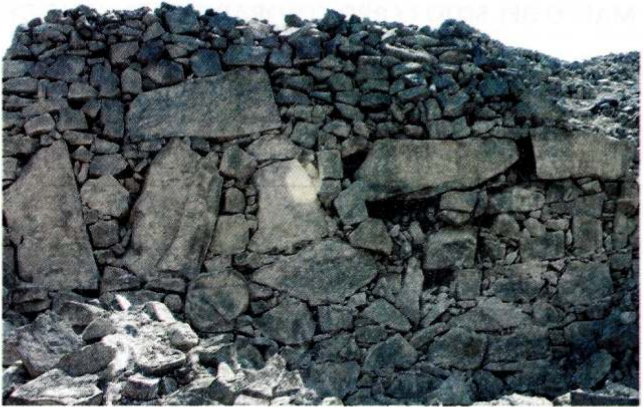
Figura 2 Actualmente, esta sección del muro se encuentra en muy débil estado. Se nota algunas piedras han sido sacadas. Foto por M. Brown Vega.
